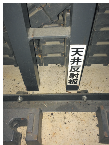
メインホールの反響板ガイドレールが破損
