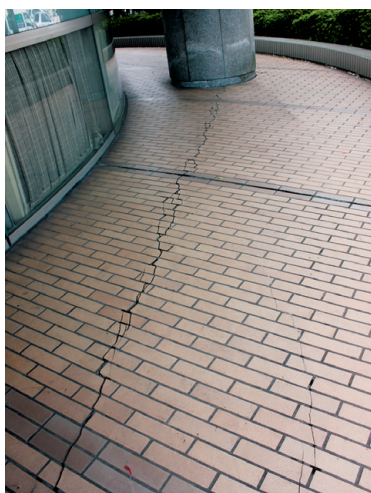
タイルに亀裂が入った玄関前
